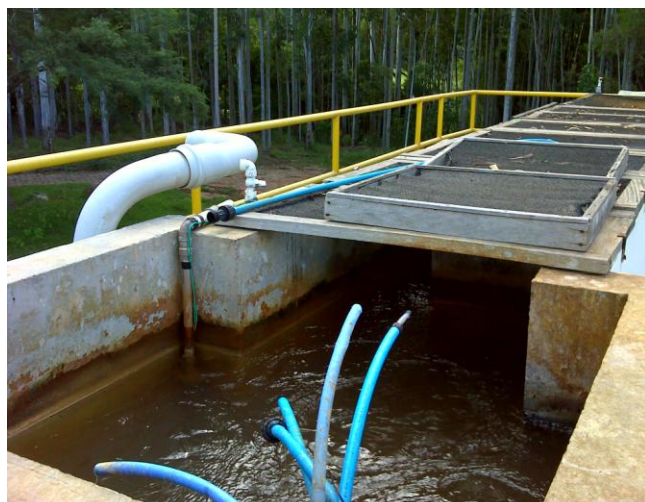
FOTO 4.5 ETA – ENTRADA DE ÁGUA BRUTA
