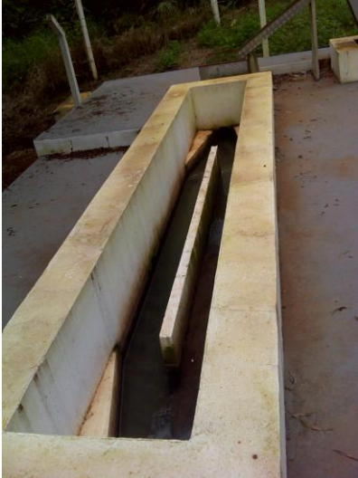
FOTO 4.37: CAIXA DE AREIA
