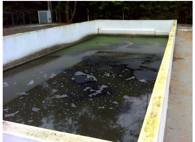
FOTO 4.40: LAGOA DE MATURACÃO (ANAERÓBIA)
