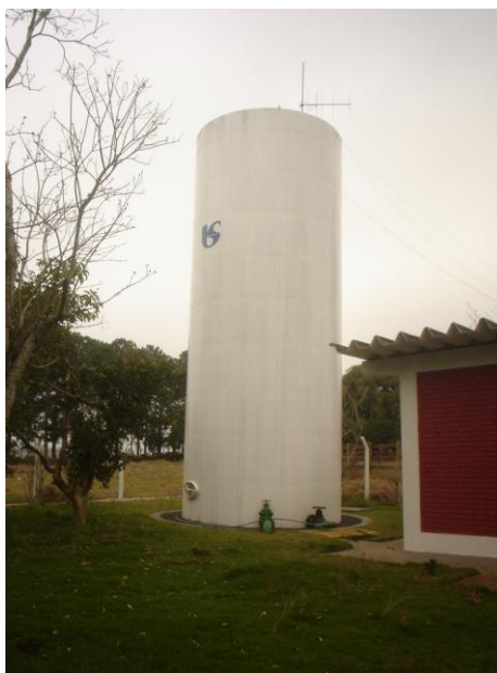
FOTO 4.21 – RESERVATÓRIO BOM RETIRO DA ESPERANÇA
